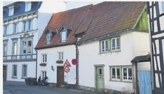
Nach der baulichen Bestandsaufnahme rechnet der Verein „Iserlohn - denkmal“ damit, dass die Sanierung im kommenden Jahr erfolgen kann.
